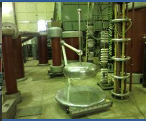
Високовольтне обладнання кафедри
